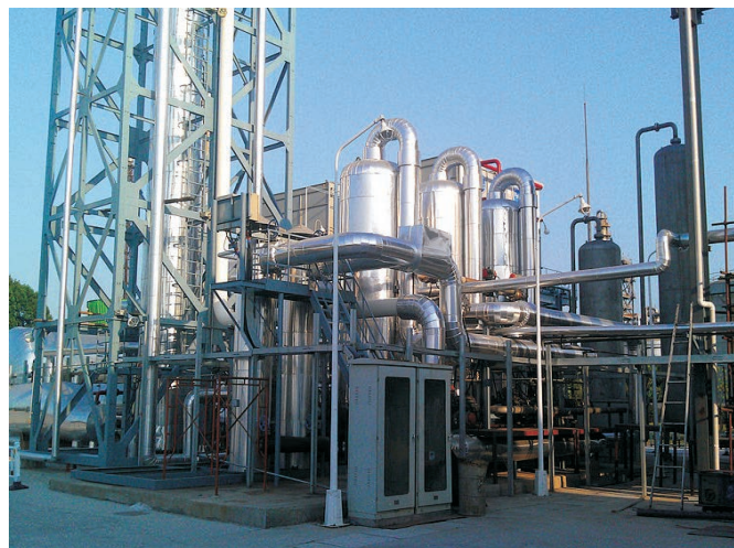
Установка для рекуперации и очистки CO 2 (200 000 тонн в год)
